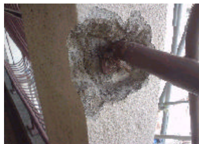
(錆びた手摺の付け根は削りだす)
